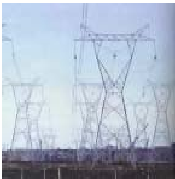
Torres de Alta Tensión en 500 kV
