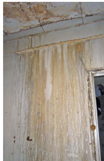
Fuite d'eau provenant de l'étage supérieur ainsi que de la salle d'eau
