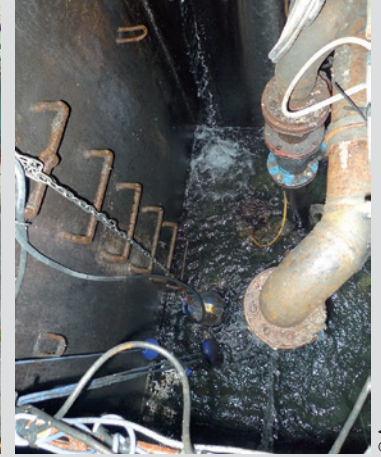
Rejet d'eaux d'exhaure du parking Basilique
