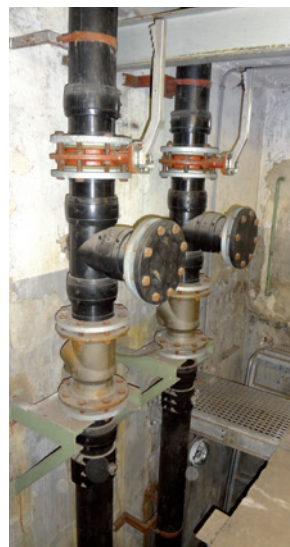
Pompes d'un poste d'épuration de la RATP
