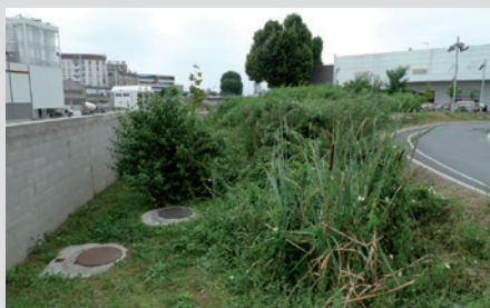
Dernière épuration des eaux noires avant injection en nappe
