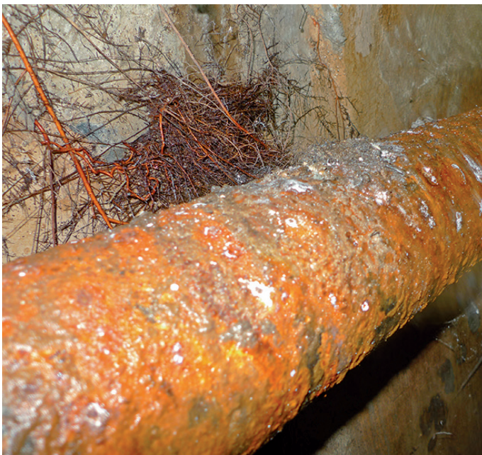
Racines dans les égouts, quartier de l'Observatoire, Paris 14 e
