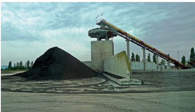
La station d'épuration Seine Aval : les bassins de décantation, les boues issues du traitement des eaux usées, le rejet des eaux épurées dans la Seine
