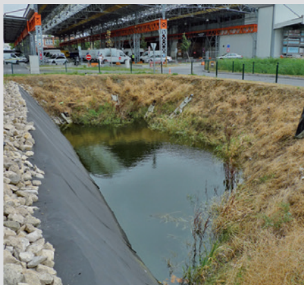
Bassin de récupération des eaux de toitures
