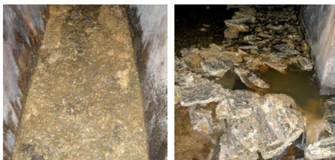
Accumulation de graisse rejetée par les restaurants dans les égouts due au dysfonctionnement des réservoirs de chasse
