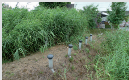
Ventilation de cuve eaux noires enterrée
