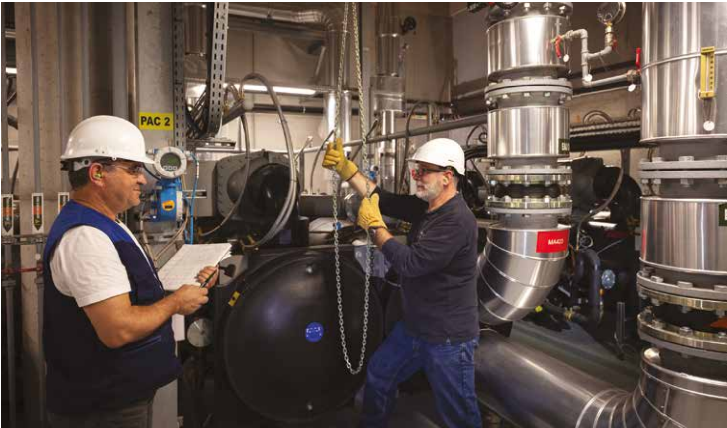
Installation d'arrivée d'eau chaude de la nappe captive de l'Albien, dans la centrale géothermique de l'écoquartier Clichy-Batignolles (Paris, 17 e arr.).
